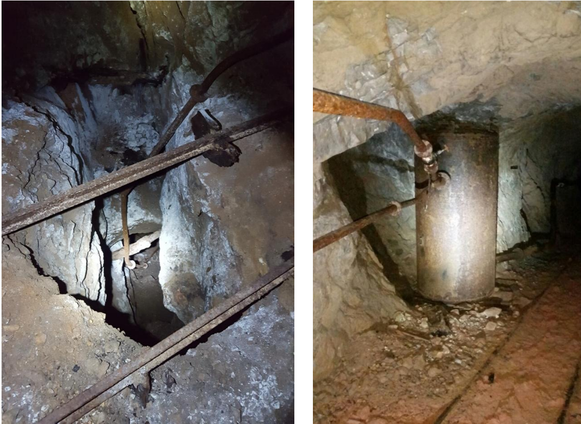
Figura 56. Restos de tubería, raíles y calderín. (Fuente: propia)
