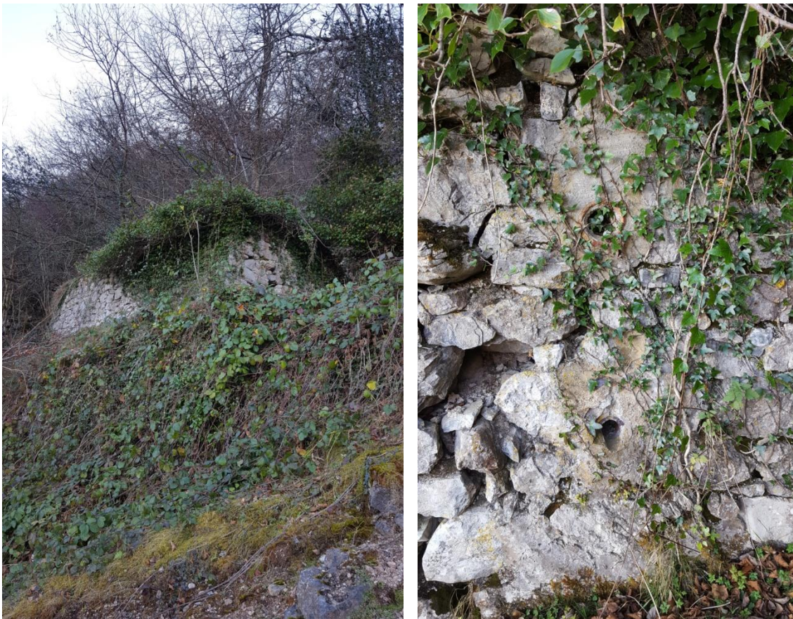
Figura 71. Construcción para la captación de agua de la fuente de Sayán en el piso 2º antiguo. (Fuente: propia)
