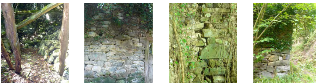
Figura 2. Fotomontaje de lesiones constructivas. A) Vista interior de uno de los habitáculos arruinados. B) Vista de un tramo del muro longitudinal. Se observa un estrato de mampostería bien trabada que a la altura del cargadero se vuelve irregular y los tallos de la yedra penetran con más vigor. C) Vista de uno de los muros transversales, en el encuentro con el muro longitudinal, cuyo desplome ha provocado una importante grieta. D) Vista del extremo norte. Se aprecia el desplome del muro y la pérdida de trabazón entre los mampuestos y sillares de la esquina. IFuente: David Ordóñez)
